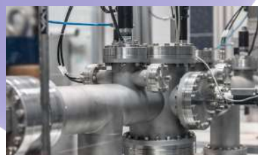
Tratamiento unificado de agua
